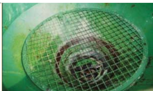
Griglia di protezione nella tramoggia di carico. (Foto Di Martino)
